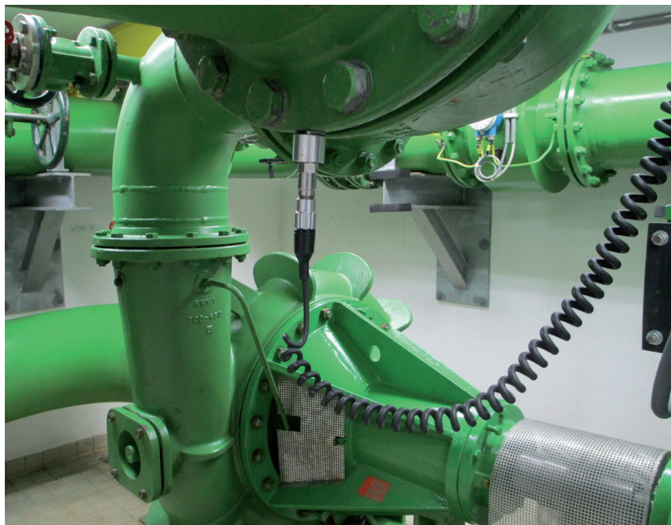
Trillingsanalyse detecteert faalmechanismes als resonantie in leidingwerk
